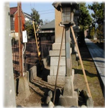
【応急処置をした灯籠と鋼管柱】
